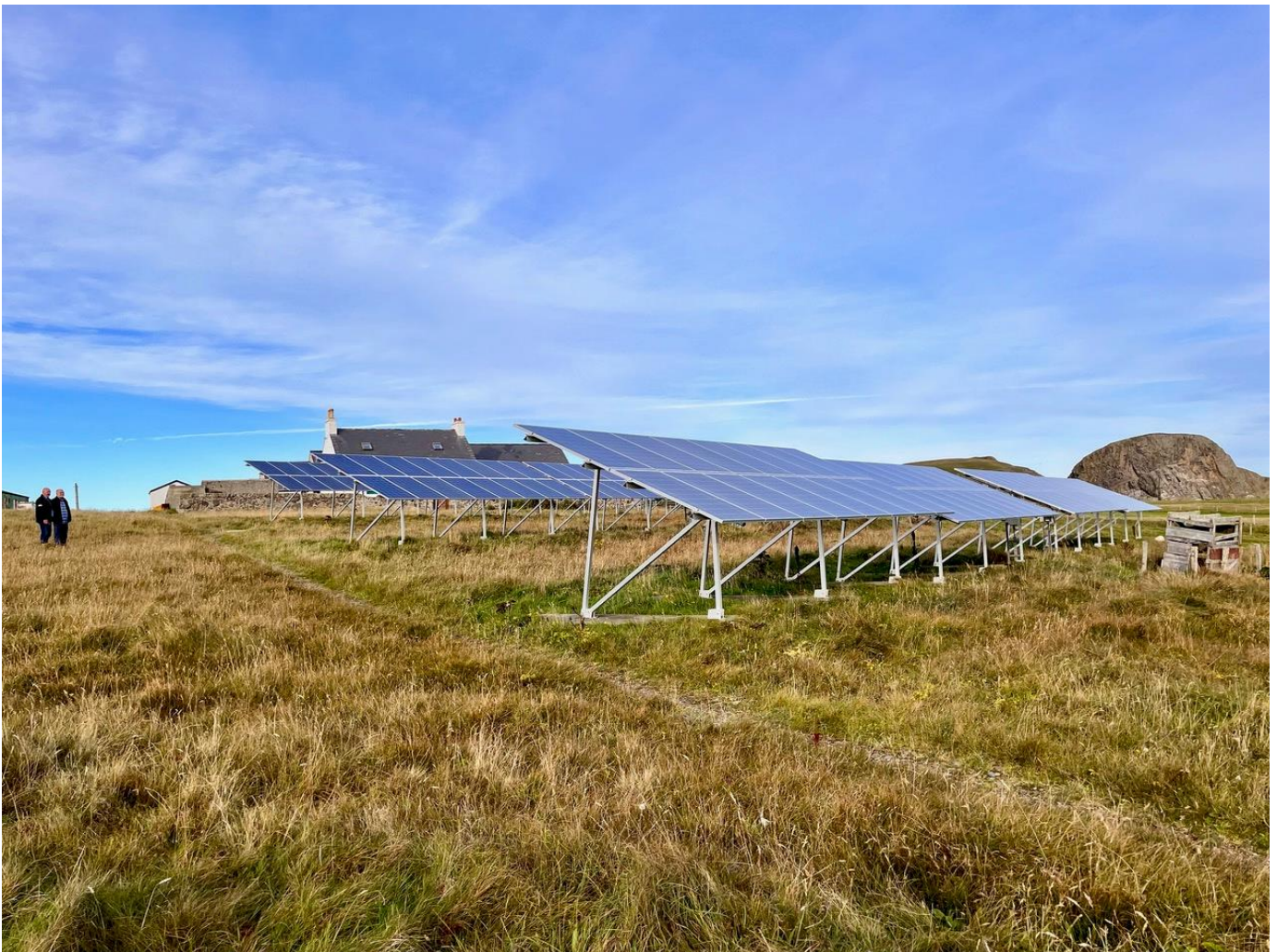
Solar Array x 3
